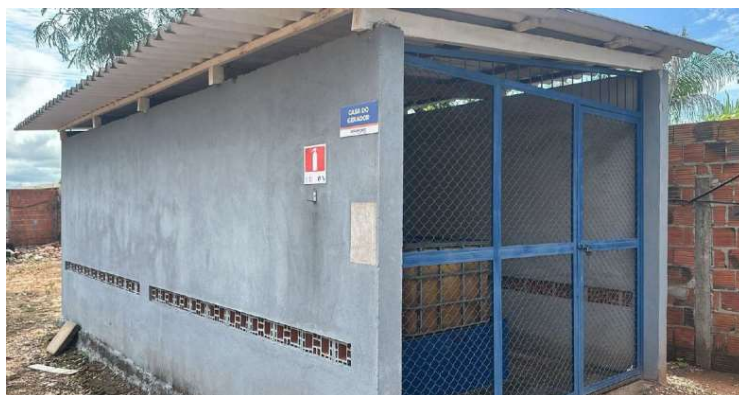
FIG 42: GERADOR PRÓPRIO DA USINA
